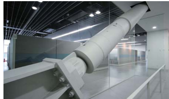
工厂内约配备有570台防震缓冲装置，可吸收地震所产生的冲击
